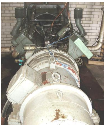
Slika br. 21. Agregat za električnu energiju
