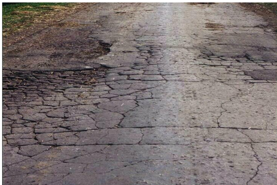
Слика 7 – оштећења коловозног застора
